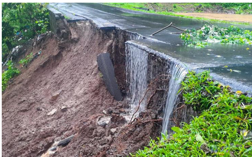
La calle alterna que de San Pedro Nonualco conduce a Santa María Ostuma, La Paz, fue cerrada debido a que una parte de la calle se derrumbó. Foto Diario Co Latino/@PNCSV.
