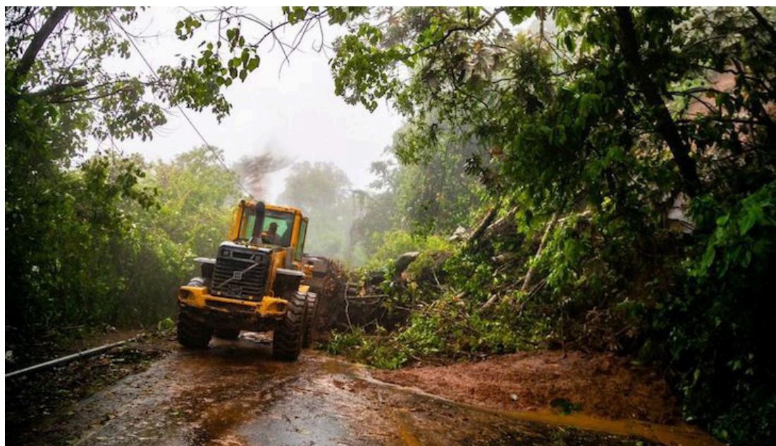
Personal de FOVIAL removió derrumbes sobre la carretera que de Apaneca conduce a Jujutla, en Ahuachapán. Foto Diario Co Latino/@SecPrensaSV.
