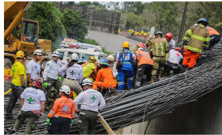
La información preliminar del accidente laboral en el viaducto Los Chorros, indica que se cortaron unos cortaflujos, es decir, las estructuras de madera utilizadas para el llenado de las bases, provocando la caída de las varillas de hierro. Foto Diario Co Latino/cortesía.
